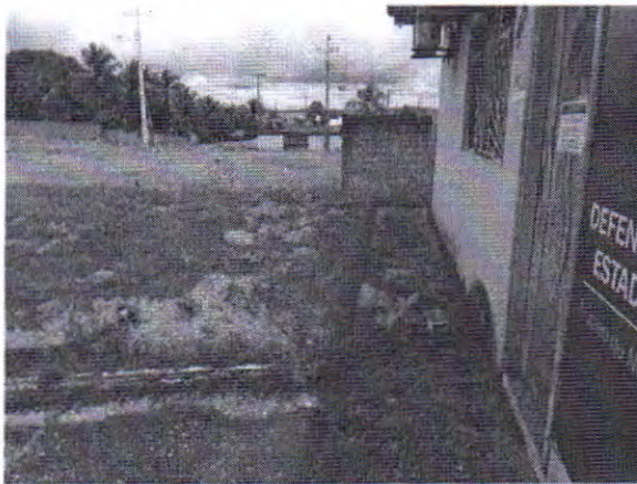
imagem 08 (ausência de muros de proteção nos arredores do imóvel)
