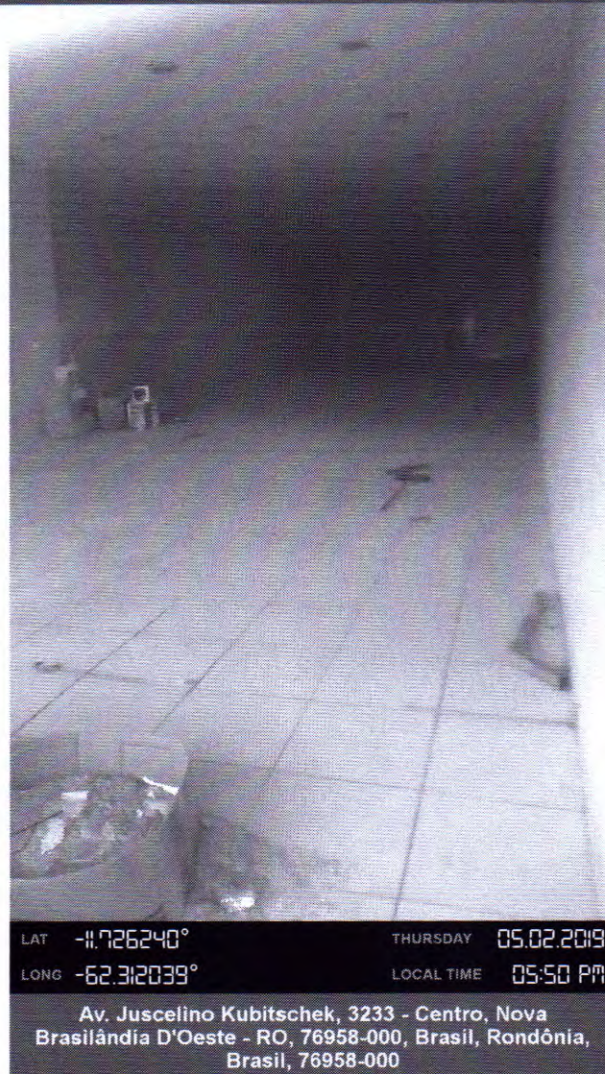
Figura 4 Vista interna direita do único salão do imóvel que pode ser dividido por uma parede de divisória.
