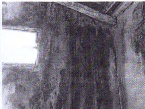
Imagem 07 (Paredes internas do banheiro de uso comum, presença de fungos/mofo)
