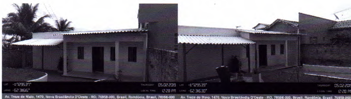
Figura 3 - Vista da entrada do imóvel com piso em argamassa desempenada, necessita de adequação com rampa, para respeitar as exigências da NBR 9050.
