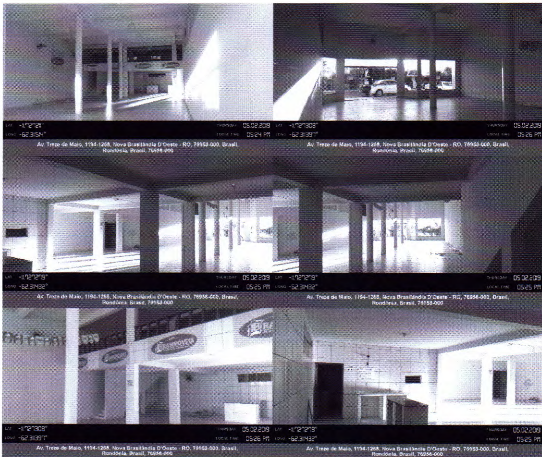
Figura 4 Vista interna do único salão do imóvel que pode ser dividido por uma parede de divisória.
