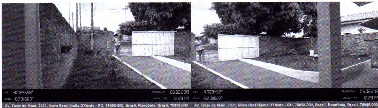
Figura 4 - Vista da entrada do imóvel pra com a entrada do terreno, com piso em argamassa desempenada, necessita de adequação com rampa, para respeitar as exigências da NBR 9050.
