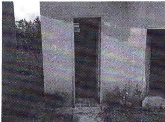
Banheiro de acesso ao público inacessível (ausência de rampa e porta inadequada)
