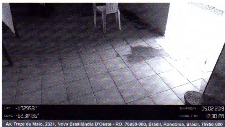
Figura 6 - Vista interna do salão apontado o desgaste acentuado da cerâmica.
