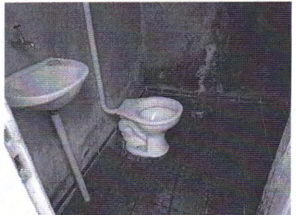
Imagem 05 (interior, ausência de acessibilidade e condições inapropriadas de uso)
