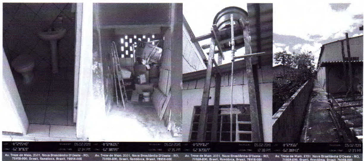
Figura 10 - Vista de um banheiro externo para atender servidores, de um depósito sem porta, da sustentação da caixa d'água e dos fundos do imóvel não oferecendo segurança.
