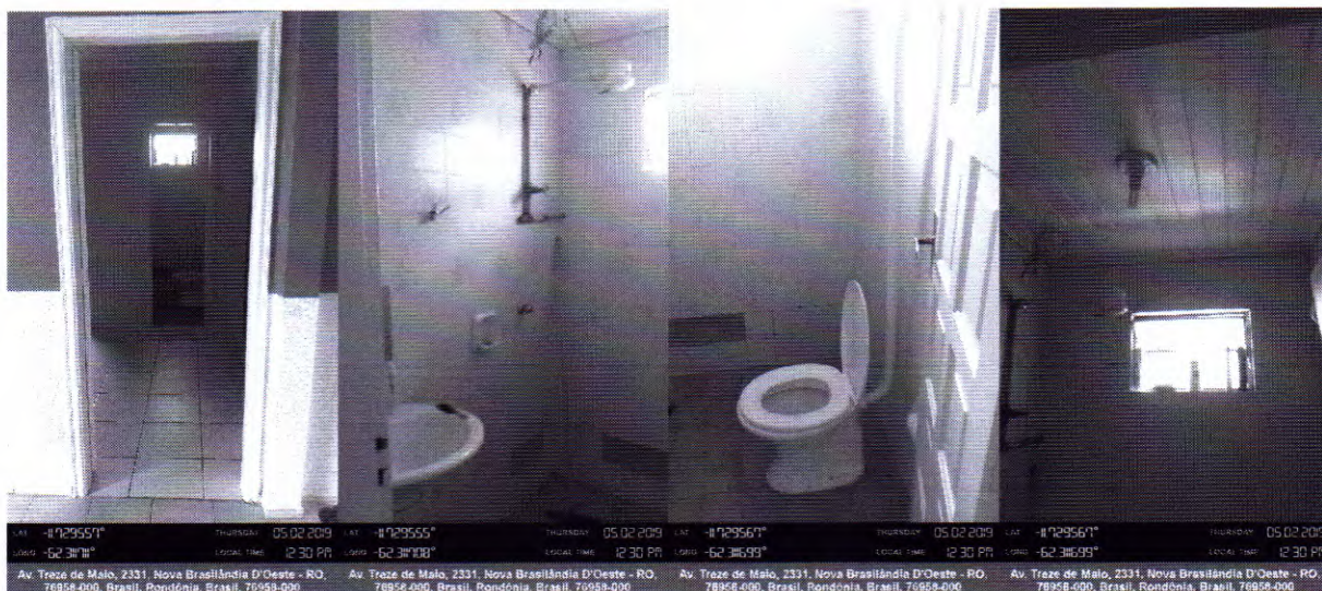
Figura 7 – Vista do banheiro interno que necessita de uma reforma geral
